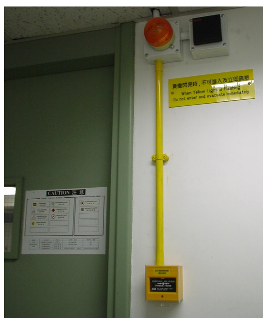
緊急排風警報安裝在實驗室入口旁
